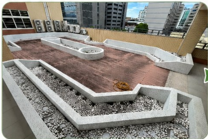
原4樓屋頂僅鋪白石，缺乏植栽與隔熱效果，夏季高溫不適，閒置未有效利用。
